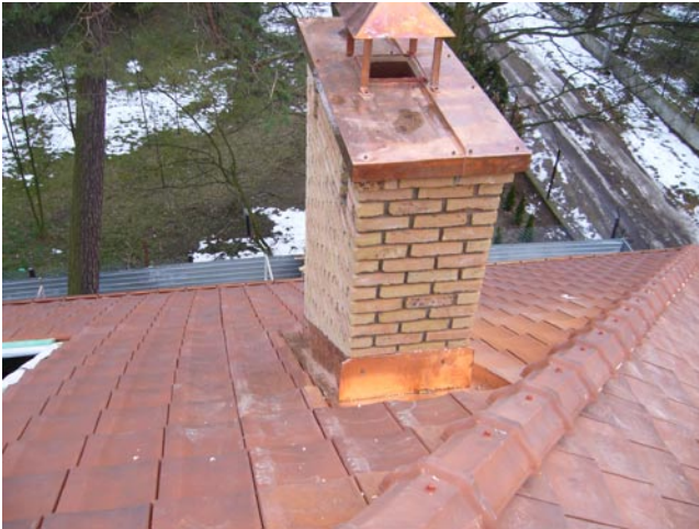
Komin solidnie obróbiony blachą z góry i z dołu
