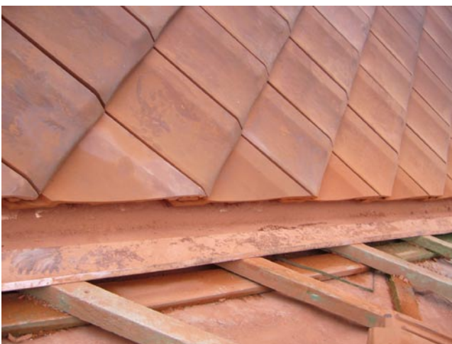
Pogrążony kosz, częściowo zakryty
