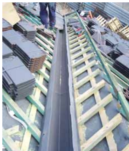
▲ Nisko osadzony kosz, zabezpieczony klinami z gąbki
