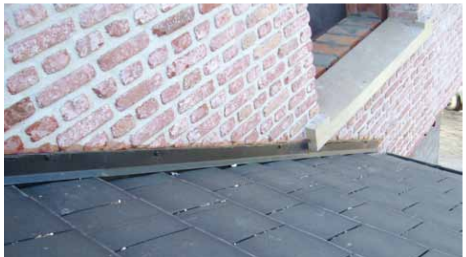
▲ Dwuczęściowa obróbka przyścienna...
