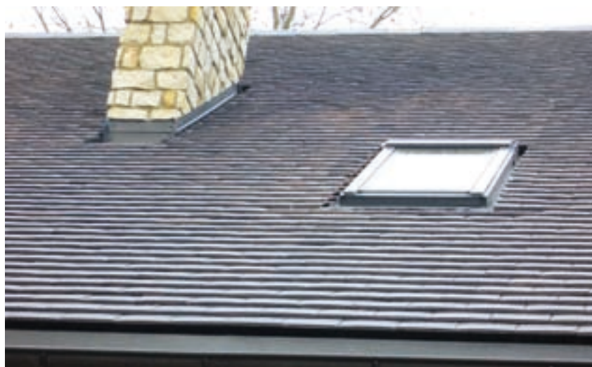
Obróbki komina oraz okna dachowe zostały zagłębione w łątach na ok. 15 mm
