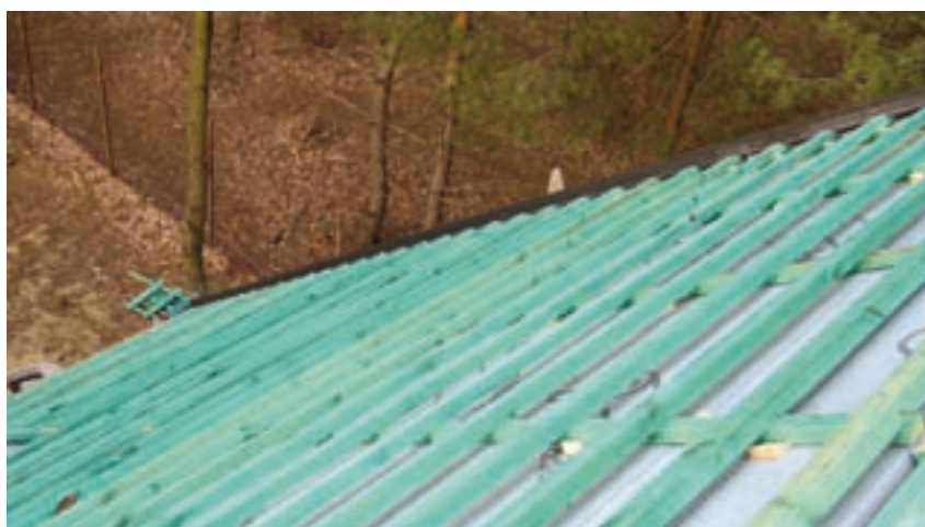
Łacenie pod matą dachówkę było bardzo gęste. Widać kliny prostujące połąć
