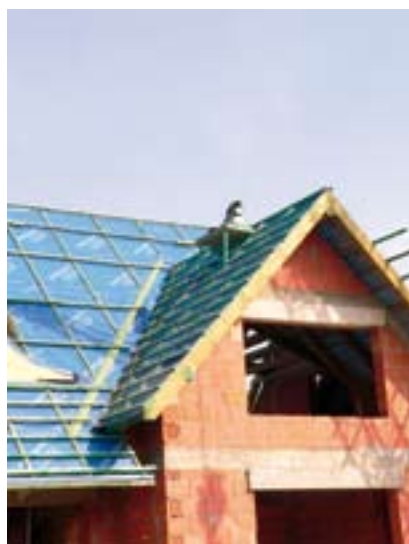
Dla chcącego nic trudnego: nawet z krótkim przewodem do sprężarki można sobie poradzić
